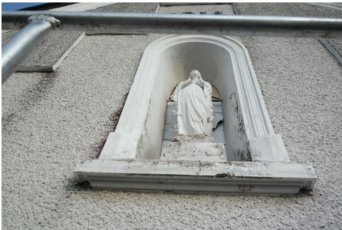
Fot. 12. Oprawa wnęki z figurą Matki Bożej z Lourdes z widocznym wypracowanym w zaprawie kapinosem parapetu.
