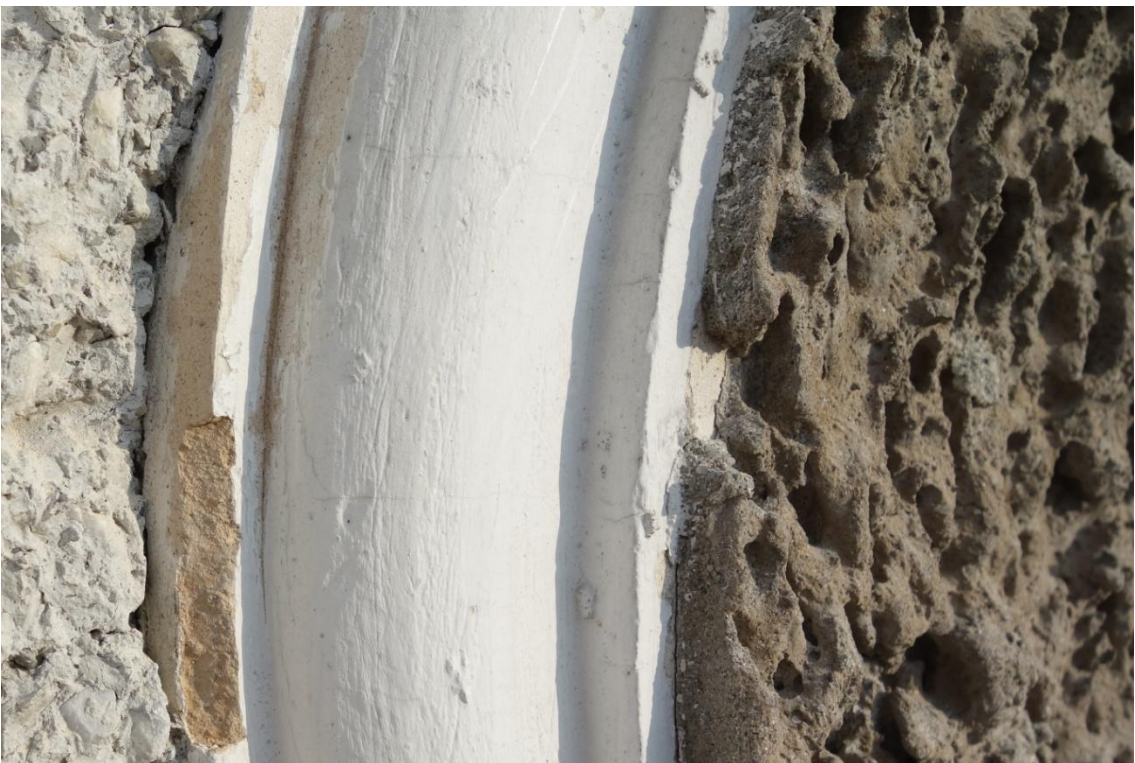
Fot. 7. Zbliżenie barwnej zaprawy sztukatorskiej kolorze jasnopiaskowymi na ubiciu profilowanego obramienia okrągłej zdobiny umieszczonej w centrum płyciny poziomej nad wejściem głównym.
