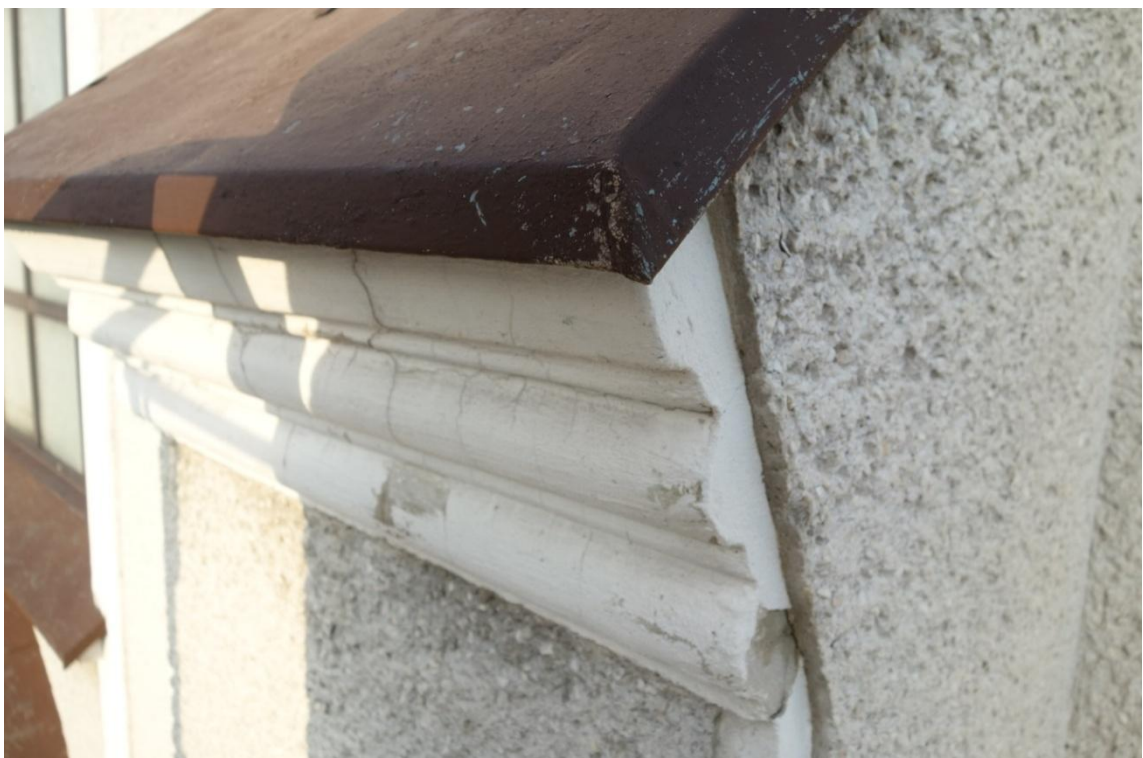
Fot. 22. Zbliżenie przebiegu gzymsu na uskokowej przyporze – po prawej stronie w widoku na wprost – zaprawy późniejsze w kolorze szarym.
