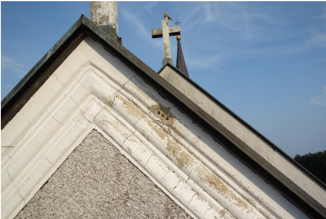
Fot. 18. Szczyt fasady kościoła, profile ciągnięte z późniejszej zaprawy w kolorze szarym.
