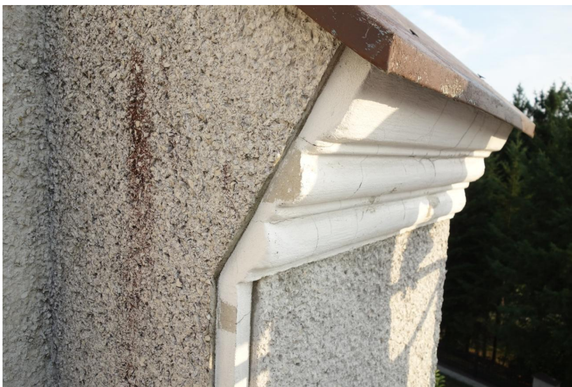
Fot. 20. Przypora prawa fasady w widoku na wprost – profile ciągnięte oraz listwy narożne z zaprawy późniejszej w kolorze szarym. Fot. H. Granek - Smarzewska
