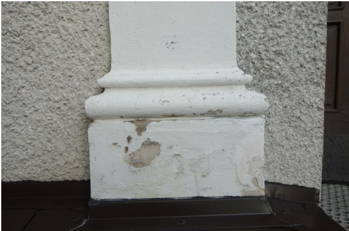
Fot. 24. Zbliżenie cokołu oprawy wejścia bocznego, prawego do kościoła (w widoku na wprost) – wyprawy starsze, barwione w masie w kolorze jasnopiaskowym. Fot. H. Granek - Smarzewska
