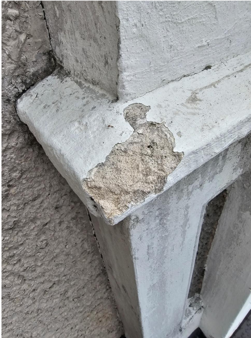
Fot. 15. W ubiciu gzymsu widoczne głębsze warstwy wyprawy w kolorze jasno piaskowym, zaprawy starsze. Fot. R. Argasiński
