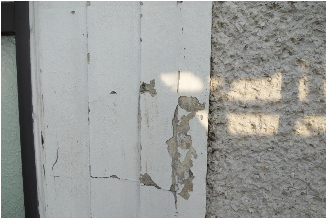
Fot. 11. Profilowana opaska okna nad wejściem głównym, zaprawy starsze w kolorze jasnopiaskowym. Fot. H. Granek - Smarzewska
