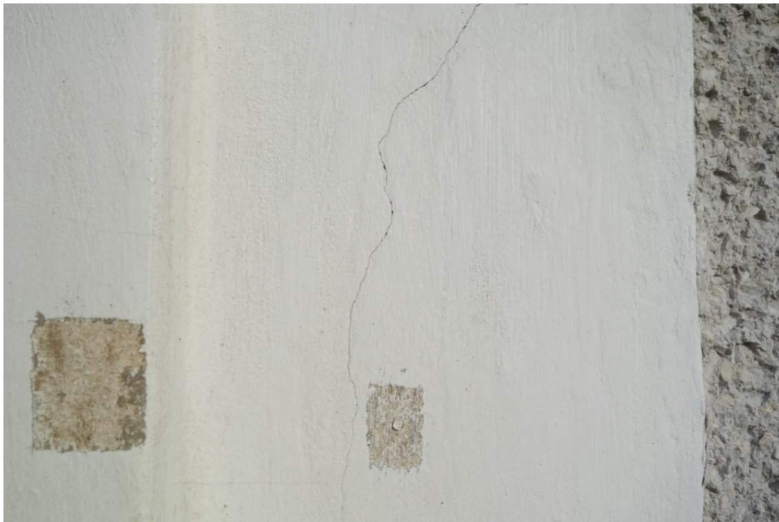
Fot. 3. Zbliżenie odkrywek na gzymsie portalu wejścia głównego, na oryginalnej wyprawie w kolorze jasnopiaskowym widoczna szlichta mineralna – cementowa oraz nawarstwienia malarskie. Fot. H. Granek - Smarzewska
