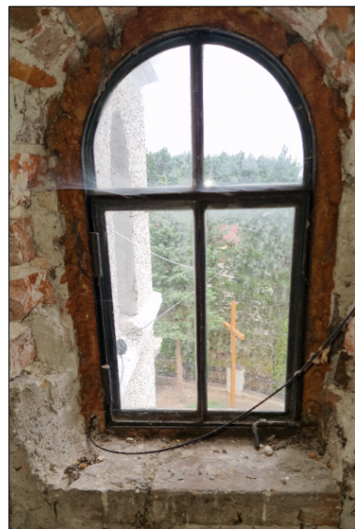
ZDJĘCIE POGLĄDOWE - STAN ISTNIEJĄCY OKNA OD WEWNĄTRZ
