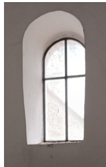
ZDJĘCIE POGLĄDOWE - STAN ISTNIEJĄCY OKNA OD WEWNĄTRZ
