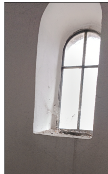
ZDJĘCIE POGLĄDOWE - STAN ISTNIEJĄCY OKNA OD WEWNĄTRZ
